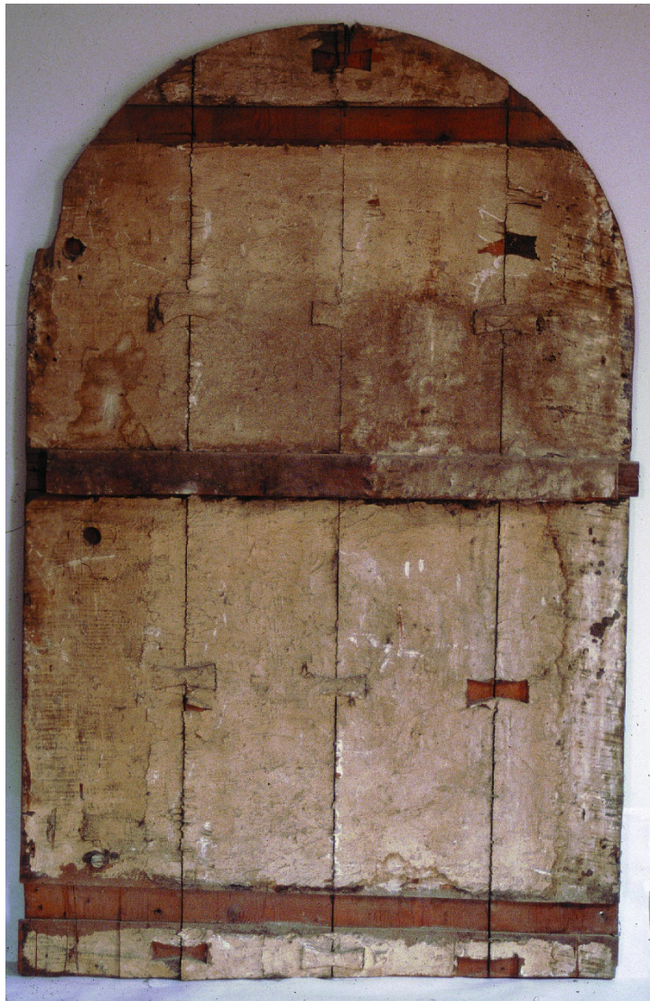
Figura 1. Reverso de la tabla de la Piedad. Retablo de la capilla del Cristo de la Misericordia de la Iglesia de San José. Granada. Recuperado de https://www.juntadeandalucia.es/organismos/culturaypatrimoniohistorico/areas/bienes-culturales/actuaciones-conservacion/intervenciones/detalle/39772.html
