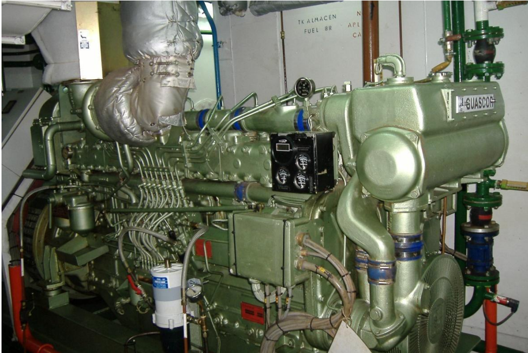
Ilustración nº1: Motor auxiliar Guascor
