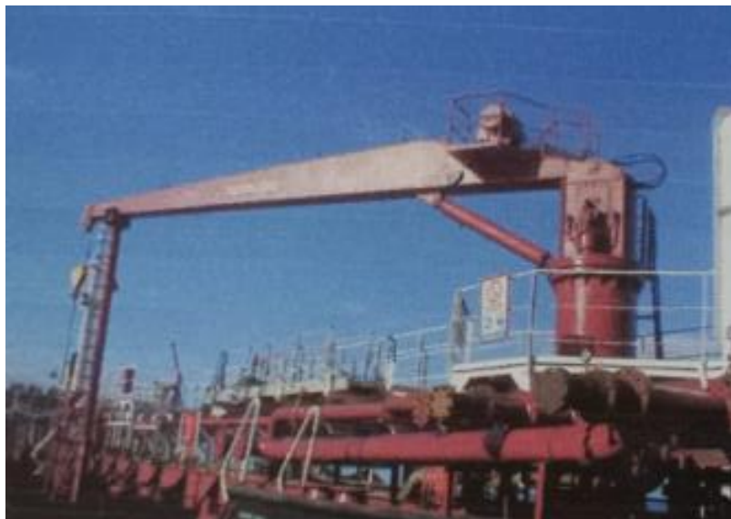
Ilustración 2: Grúa de cubierta
